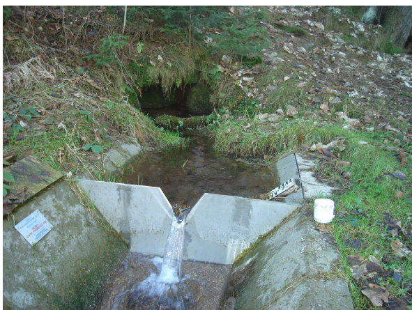
Obr. 7.10 Pramen PP0744 Želechy (před rekonstrukcí) s vysokou vydatností 1,11 l/s v září 2009. Pramen vyvěrá v severovýchodních Čechách v oblasti Podkrkonošského permokarbonu (hg rajon 5151), je součástí odvodnění pánevní oblasti s horninovým zastoupením slepenců.
